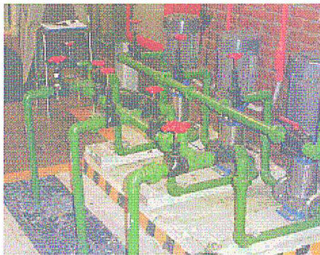
Bombas de alimentación de agua a calderas
