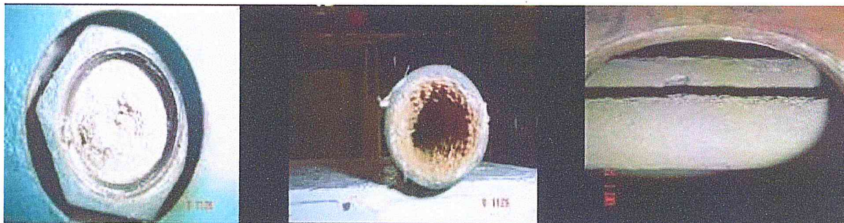
Incrustación en puerto de muestreo y tuberías de calor
